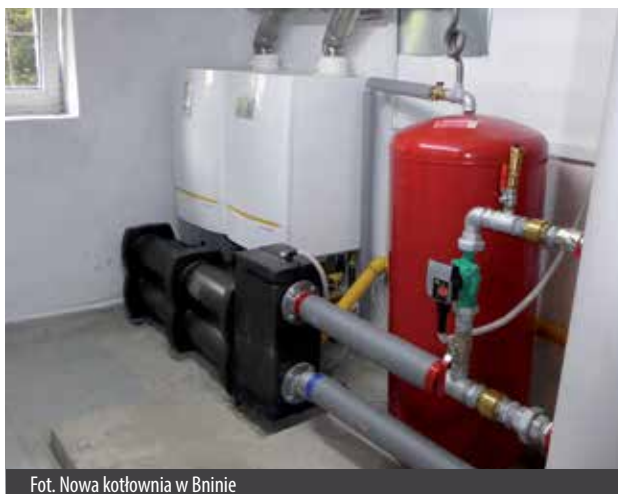
Fot. Nowa kotłownia w Bninie
