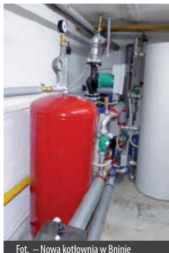
Fot. – Nowa kotłownia w Bninie
