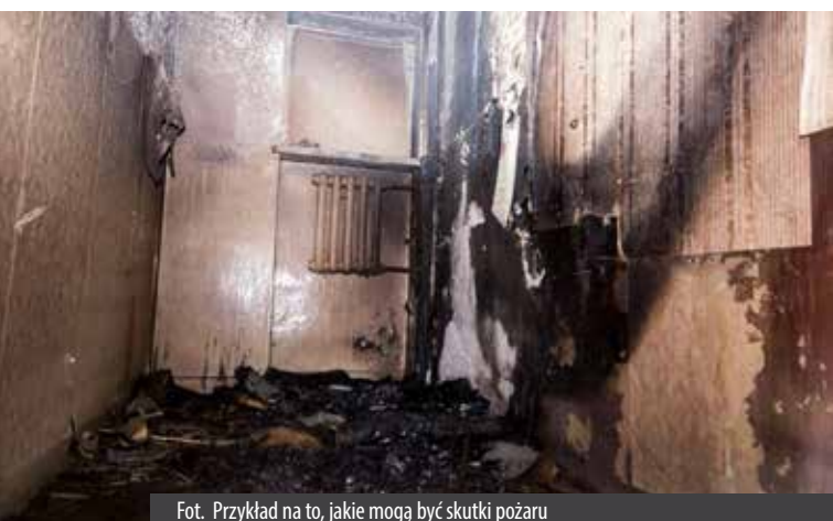
Fot. Przykład na to, jakie mogą być skutki pożaru
