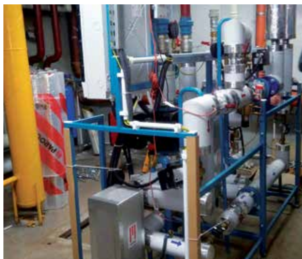
Fot. Zmodyfikowany węzeł cieplny przy ul. Głębokiej 4
